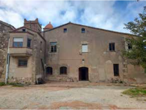
Antes de la rehabilitación
